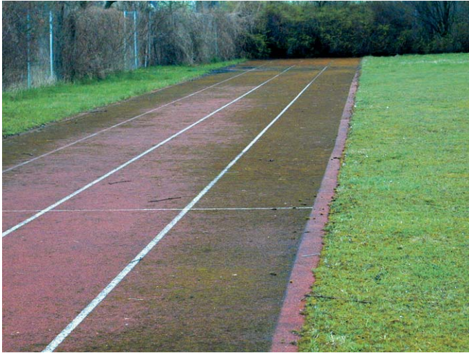
Stark verschmutzte Kunststofflaufbahn 09
